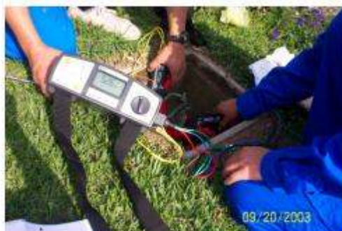
MEDICIÓN DE RESISTENCIA DE PUESTA A TIERRA CON EL MÉTODO DE LAS DOS PINZAS AMPERIMÉTRICAS
